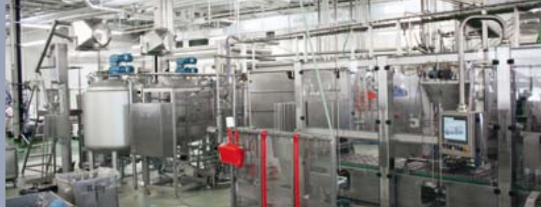
Kochanlage in Skidbauweise mit Pumpen, Verrohrung, Steuerung und Zuführung zum DOSOMAT. Skid-design cooking system with pumps, pipework, control and delivery to the DOSOMAT.
